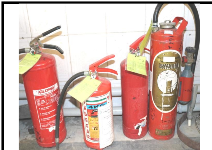
کپسول های آتش نشانی
